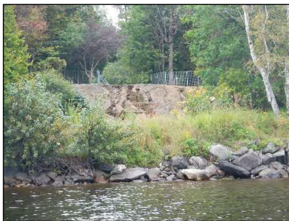
Figure 31 Forte érosion aperçue au niveau de l'intersection chemin Plante et du ruisseau, Stratford (45°47'35.00"N; 71°20'12.22"O (WGS83))
