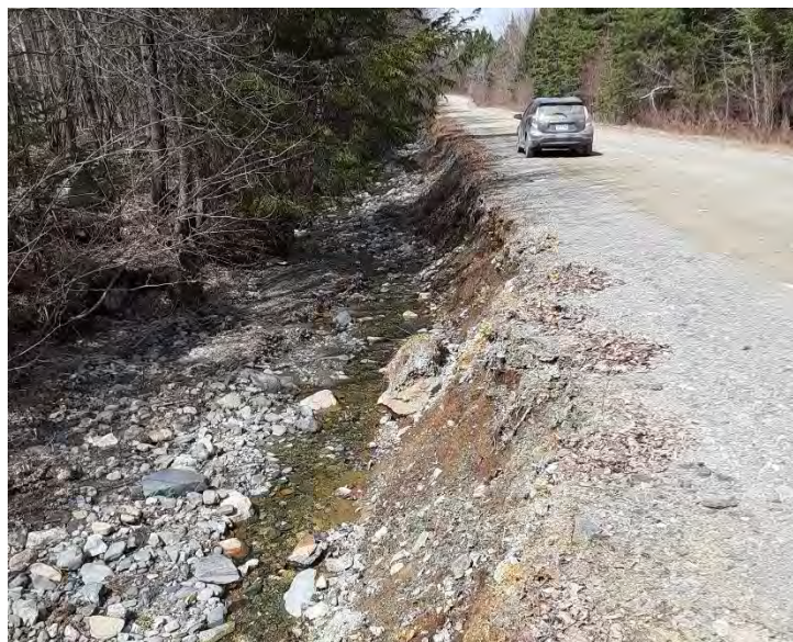
Figure 3. Érosion du fossé sur le chemin Cupra
