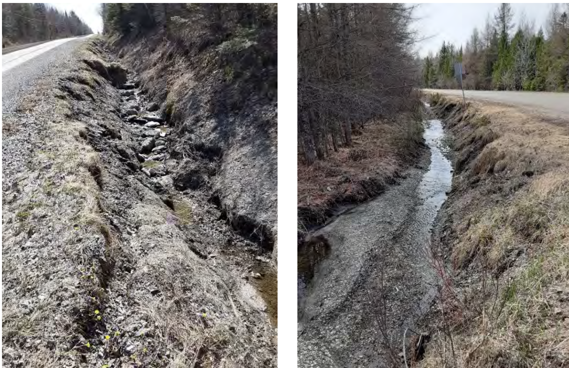
Figure 2. Érosion du fond et du talus du fossé
