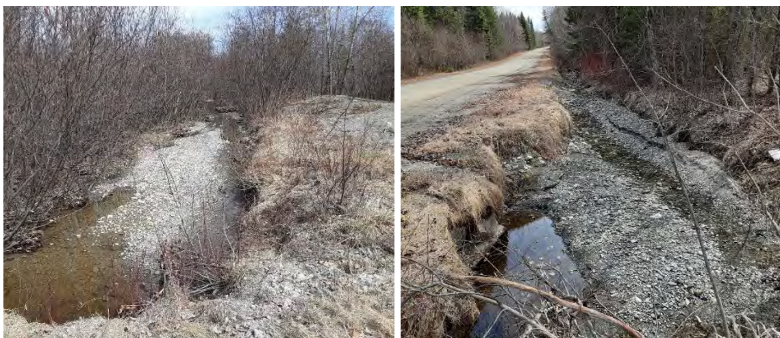
Figure 4. Accumulation de sédiments en amont et à l'aval du ponceau du chemin
