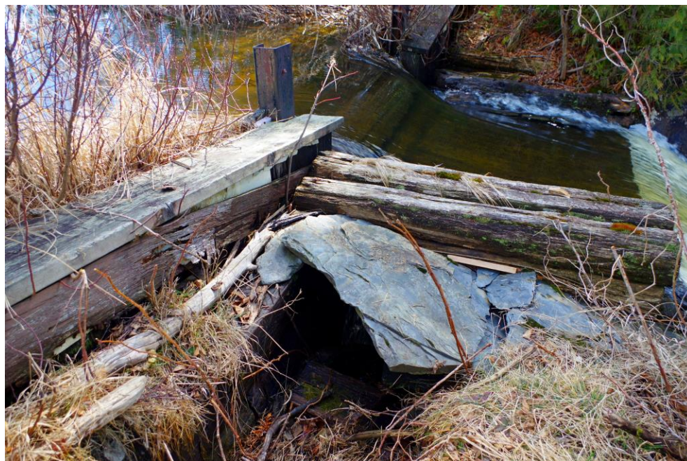
Photo 3 Vue sur la rive droite du déversoir. On remarque une forte dégradation des pièces de bois et un affaissement important de la structure.
